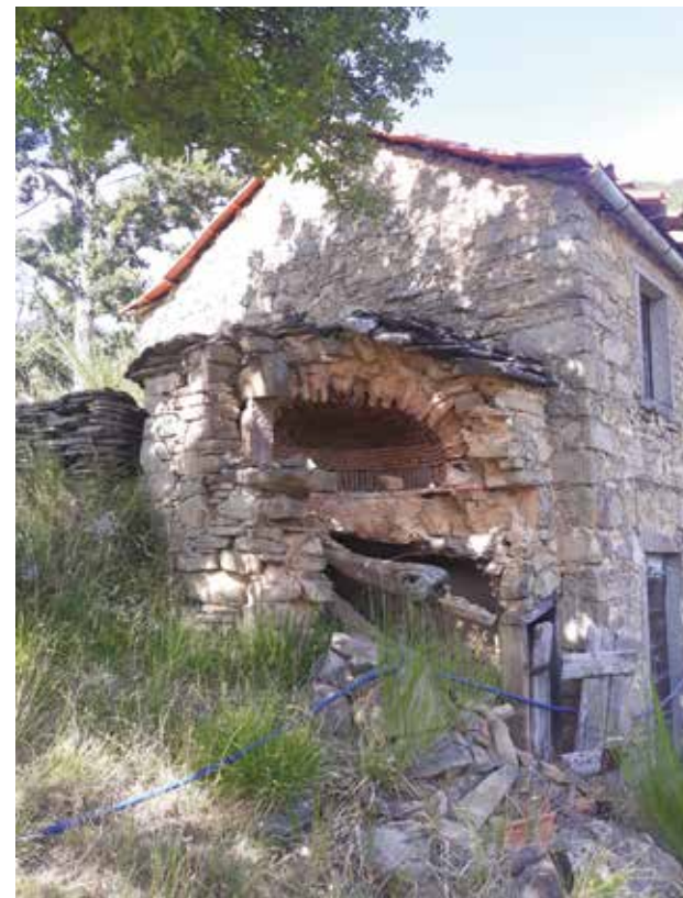
Fig. 16 Collalto, il forno da pane in rovina con la sottostante porcilaia.
