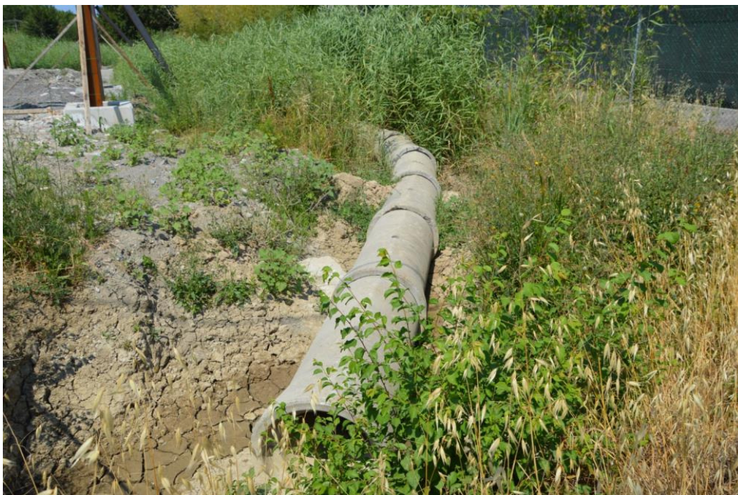
Immagine del punto di scarico e della condotta presente per il tombamento del fosso.
